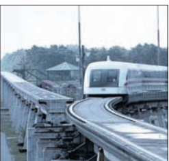
Eine Weiche für den Transrapid ist mindestens 78 Meter lang.
